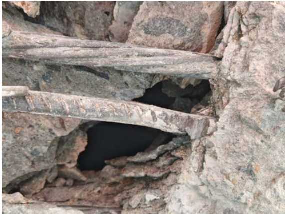
3-1空心板梁底板空洞孔洞
