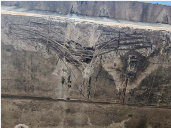
3-1空心板梁底板剥落露筋，钢绞线断裂、钢筋断裂、扭曲
