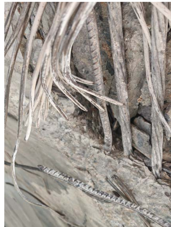
图3-7: 3-1空心板梁钢绞线断裂, 钢筋断裂
