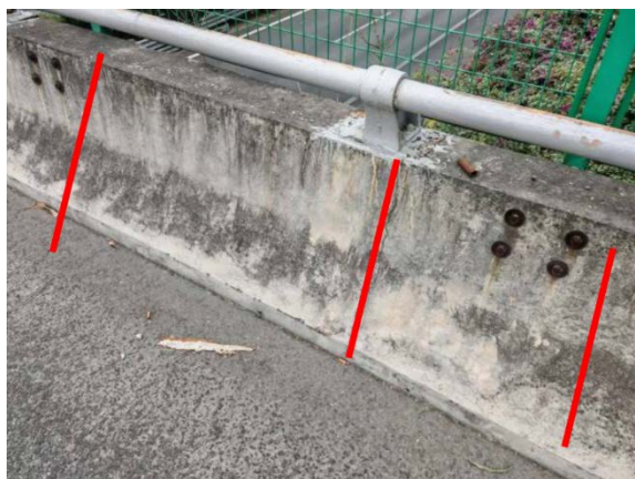
图3-1: HL-R-1护栏内侧竖向裂缝
