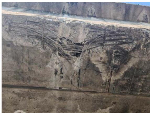
图3-4: 3-1空心板梁底板剥落露筋, 钢绞线断裂、钢筋断裂、扭曲
