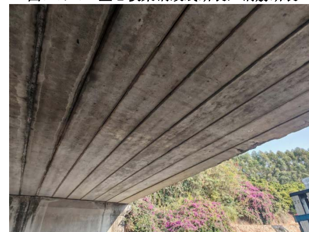
图3-9: 第3跨铰缝填料脱落
