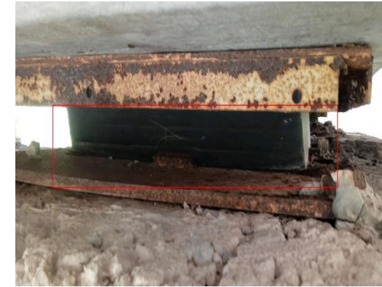
图 3-21: 上杭大桥 (上行) ZZ-8-7-2 支座: 大桩号面横向剪切; 数量: 5 个, 角度: 30°。
