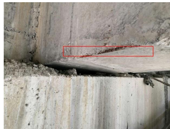
图 3-8: 上甘店大桥 (上行) 12-4T 梁: 距 12 号墩 0m 处, 左腹板露筋; 数量: 1 处, 长度: 0.3m。
