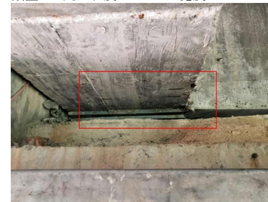
图 3-11: 坪岗 2 号大桥 (上行) 2-5T 梁: 距 2 号墩 0m 处, 梁底露筋; 数量: 3 处, 长度: 0.1m。
