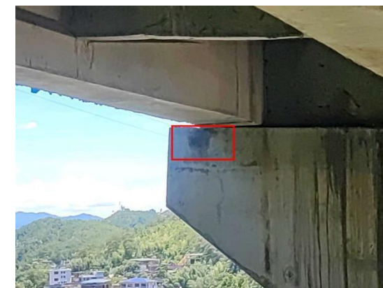
图 3-13: 上甘店大桥 (上行) GR-13D 盖梁: 大桩号面掉角; 数量: 1 处, 长度: 0.3m, 宽度: 0.3m。
