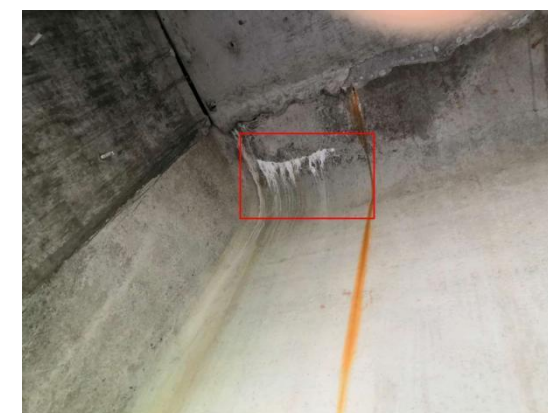
图 3-1：上甘店大桥（上行）2-4T 梁：距 2 号墩 6m 处，左翼缘板纵向裂缝；数量：1 条，长度：0.6m，宽度：0.12mm。
