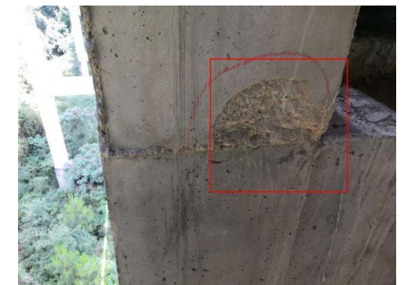
图 3-14: 坪岗 2 号大桥 (上行) GR-10D 盖梁: 大桩号面剥落; 数量: 1 处, 长度: 0.2m, 宽度: 0.2m。
