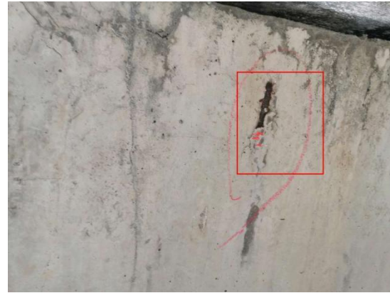
图 3-15: 上杭大桥 (上行) GR-5D 盖梁: 距左侧 1m 处, 小桩号面露筋; 数量: 1 处, 长度: 0.1m。
