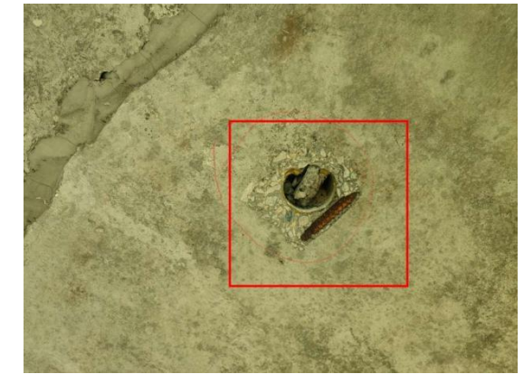
图 3-10: 山峰 2 号大桥 (上行) 2DIB 箱梁: 距 2 号墩 30m 处, 距左侧 2m 处, 梁底破损露筋; 数量: 1 处, 长度: 0.2m, 宽度: 0.2m。
