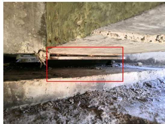
图 3-19: 山峰 1 号大桥 (上行) ZZ-1-1-5 支座: 大桩号面纵向剪切; 数量: 1 个, 角度: 20°。
