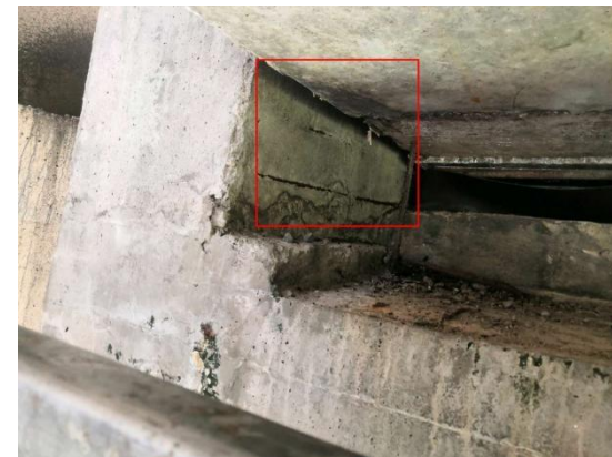
图 3-18: 小棉 1 号大桥 (上行) GL-5D 盖梁: 距左侧 0m 处, 左侧挡块露筋; 数量: 2 处, 长度: 0.5m。
