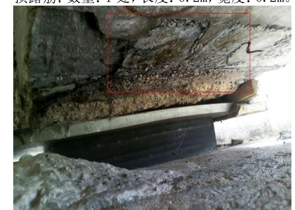
图 3-12: 上杭大桥 (上行) 2-1T 梁: 距 2 号墩 0m 起, 梁底砼夹渣; 数量: 1 处, 长度: 0.6m, 宽度: 0.2m。
