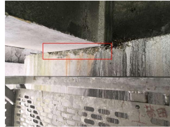
图 3-16: 上杭大桥 (下行) GL-9D 盖梁: 距左侧 1m 处, 大桩号面剥落; 数量: 1 处, 长度: 0.5m, 宽度: 0.1m。
