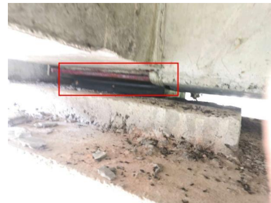
图 3-20: 山峰 1 号大桥 (上行) ZZ-6-6-5 支座: 小桩号面外鼓; 数量: 1 个, 长度: 0.1m, 宽度: 0.02m。
