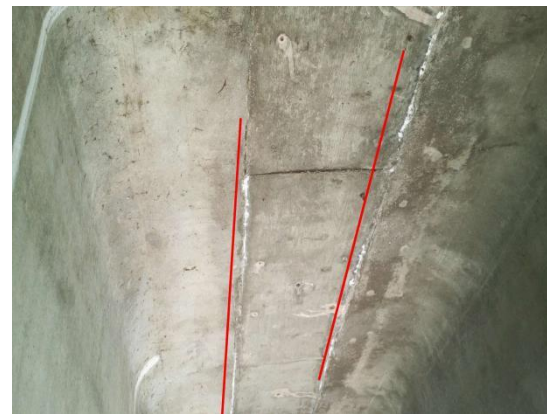
图 3-6: 上杭大桥 (上行) 3-1S 湿接缝: 距 2 号墩 5m 处, 底面纵向裂缝且析白; 数量: 10 条, 长度: 2m, 宽度: 0.12mm。
