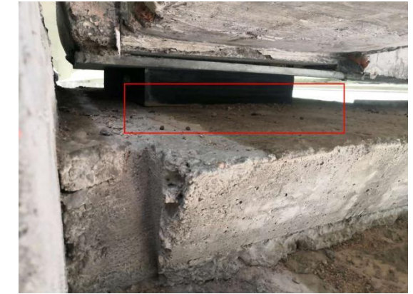
图 3-22: 小棉 1 号大桥 (上行) ZZ-17-17-5 支座: 脱空; 数量: 1 个, 百分比: 10%。
