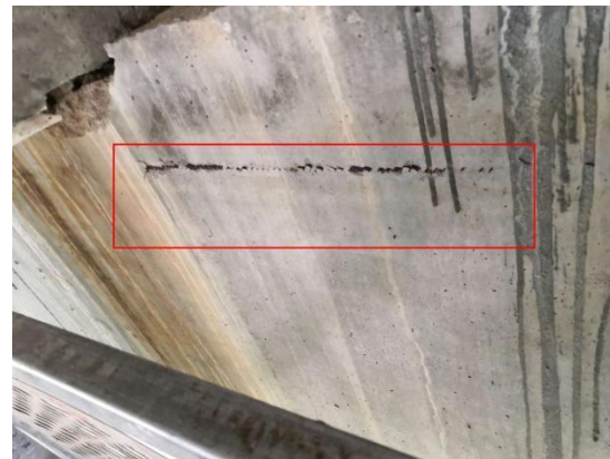
图 3-17: 小棉 1 号大桥 (下行) GL-4D 盖梁: 距右侧 1m 处, 大桩号面露筋; 数量: 1 处, 长度: 0.5m。
