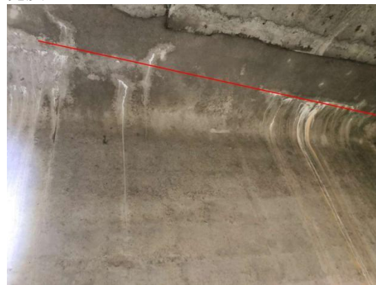
图 3-5: 坪岗 2 号大桥 (上行) 2-4T 梁: 距 1 号墩 7m 处, 左翼缘板纵向裂缝; 数量: 1 条, 长度: 1.5m, 宽度: 0.12mm。
