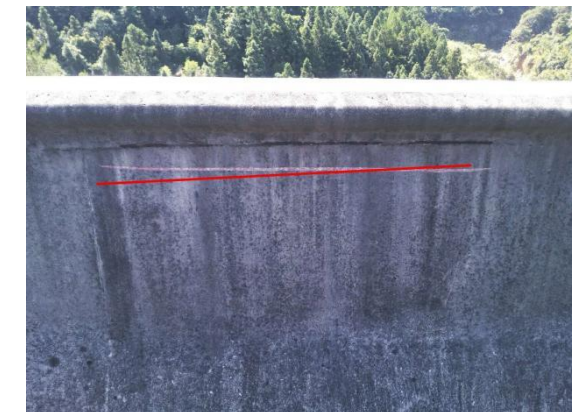
图 3-24: 小棉 1 号大桥 (下行) HL-L-1 左侧护栏: 4 号墩顶桥面, 左侧露筋; 数量: 1 处, 长度: 1.2m。
