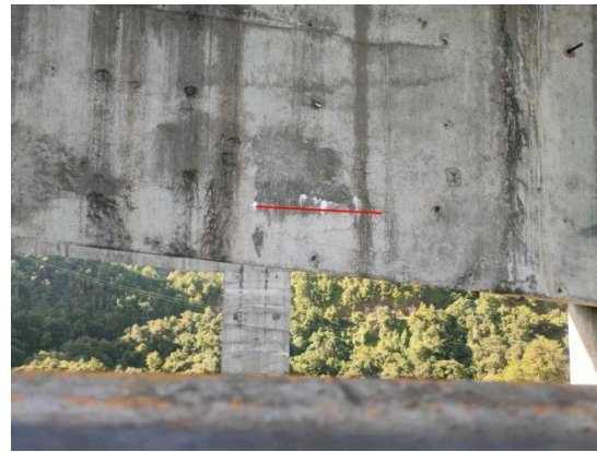
图 3-3: 山峰 1 号大桥 (上行) 3YYB 箱梁: 距 3 号墩 5m 处, 距下缘 0.5m 处, 右翼缘板纵向裂缝且析白; 数量: 1 条, 长度: 0.4m, 宽度: 0.12mm。
