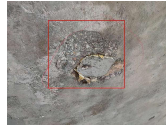
图 3-9: 山峰 2 号大桥 (上行) 3DIB 箱梁: 距 3 号台 15m 起, 距右侧 3m 起, 梁底剥落; 数量: 1 处, 长度: 0.25m, 宽度: 0.25m。
