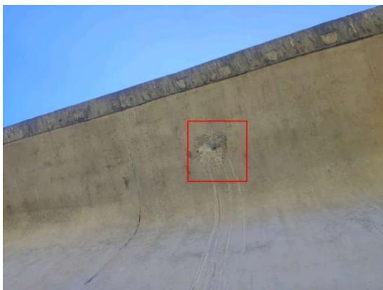
图 3-7: 上甘店大桥 (上行) 5-1T 梁: 距 4 号墩 6m 处, 右翼缘板剥落; 数量: 1 处, 长度: 0.3m, 宽度: 0.3m。
